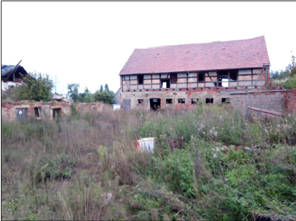
Bild 1: Das Bild zeigt die ruinöse Gebäudesubstanz im zentralen Plangebiet vor Durchführung der Abbruchmaßnahmen (Oktober 2019).
