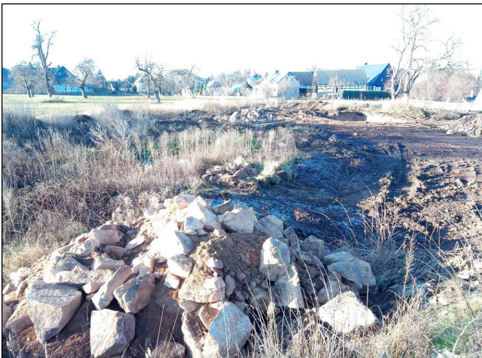
Bild 6: Nach den durchgeführten Abbruchmaßnahmen verbliebene Materialablagerungen innerhalb des Plangebietes (Januar 2020).
